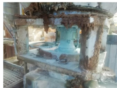
Fig. 1 – Fuga abundante pelo empanque mecânico do veio do agitador
